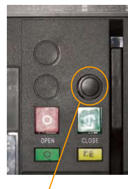
电气合闸按钮
